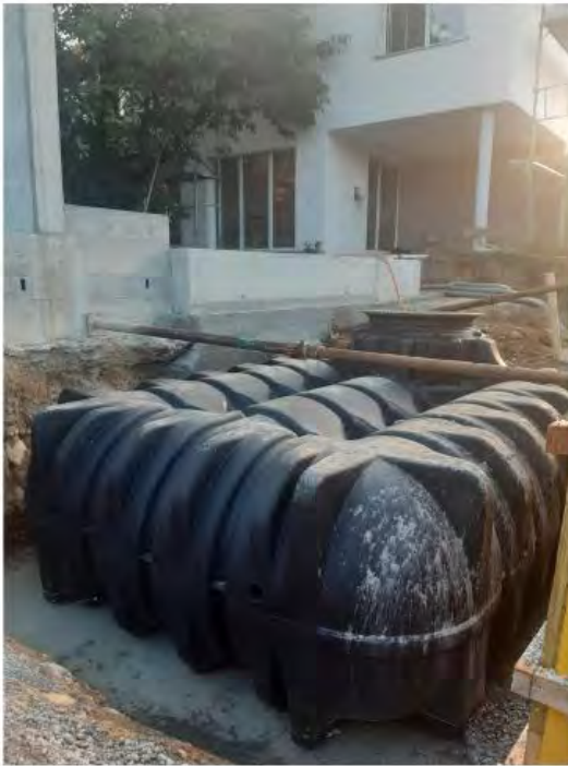
Regenwasserbecken für den Pool
